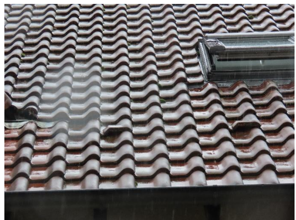
Abb. 18: Offene Lüfterziegel am Schaftrieb 9
